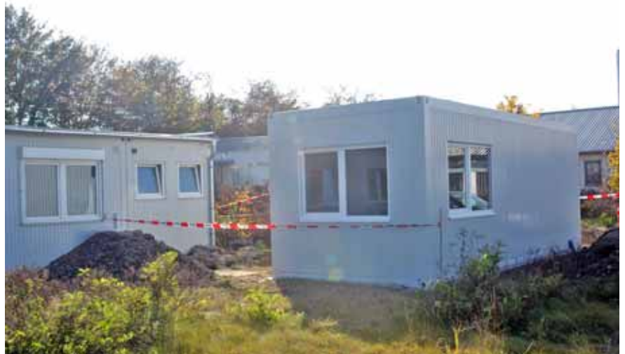
Noch eine Baustelle: Der Container für die „Kindersprechstunde“ auf dem Gelände des Klinikums
